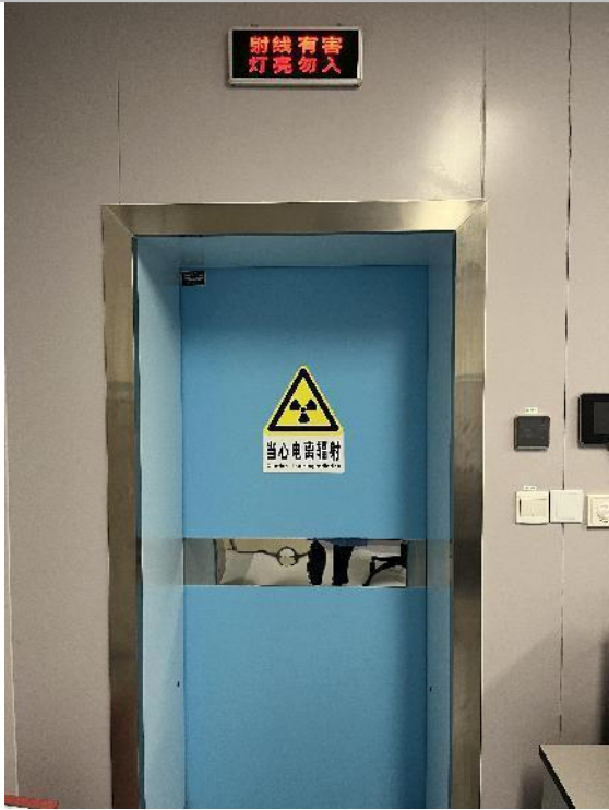
控制室防护门、警告标志、工作指示灯
