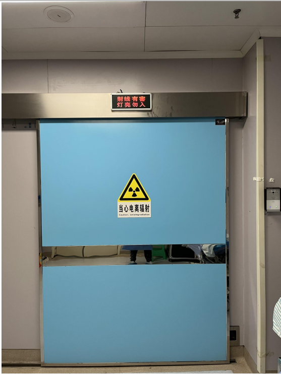
机房防护门、警告标志、工作指示灯
